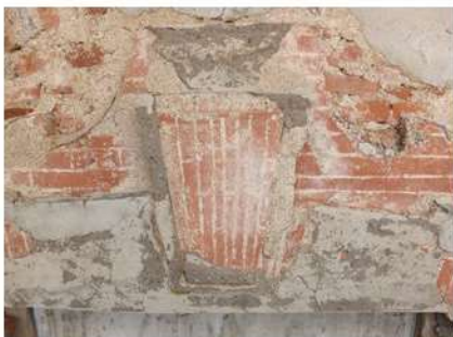
2. Dettaglio cornice in aggetto di apertura sul prospetto nord. Sono evidenti i lacerti di finitura ad intonaco con finta cortina, incisa e dipinta.
